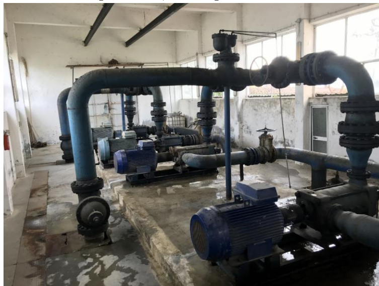
Figura IV-63: Pompave në stacionin e shpërndarjes (foto nga eksperti)
