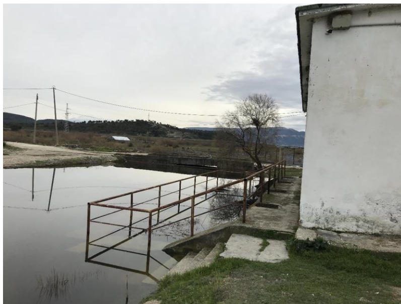
Figura IV-21: Portat hyrëse të Hidrovorit të Goricës
